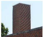
Chimenea de imitación oculta 15 antenas de panel
