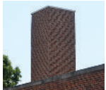
Chimenea de imitación oculta 15 antenas de panel
