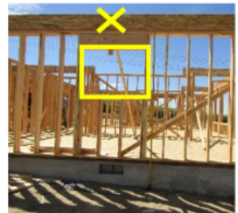
El instalador de estructuras cayó de la viga de borde (x) sobre la abertura de la ventana y hasta el entablado del piso.
