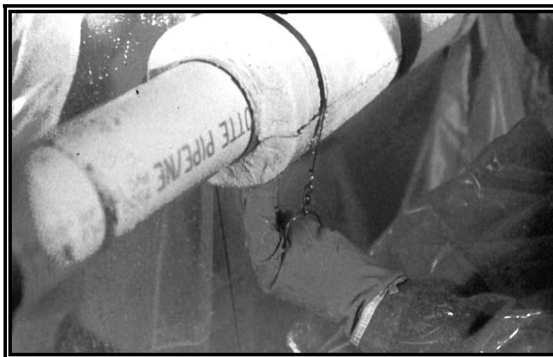
Uso de una sierra para quitar la cubierta de ACM de una tubería, en una bolsa-guante
